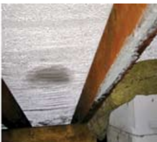
Рис. 6. Образование конденсата и грибка на наружных поверхностях чердака
