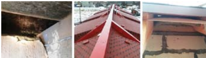
Рис. 13. Вентканал перекрыт фасадным утеплителем
