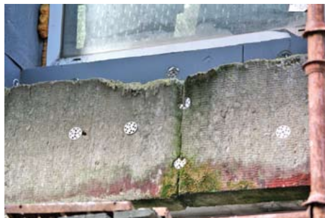
Рис. 1. Внешний вид пораженной грибом минеральной ваты на фасаде: биообращание, вызванное сообществом микроорганизмов — грибов, водорослей, мхов
