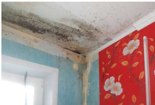
Рис. 2. Последствия попадания влаги в толщу фасада, распространение поражения внутри здания из-за нарушения вентиляции и влажности
