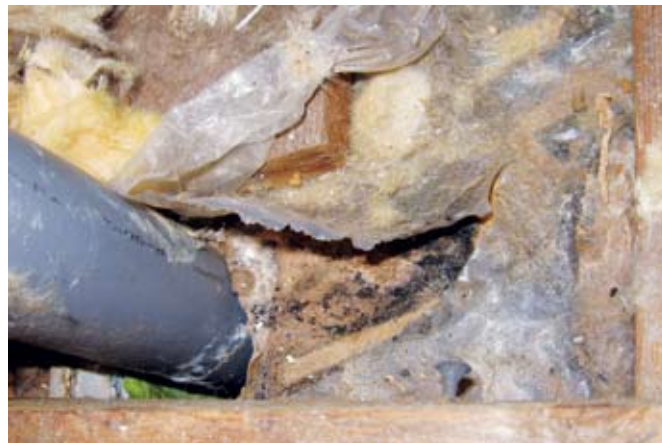
Рис. 3. Рост колоний плесневых грибов в минераловатном утеплителе
